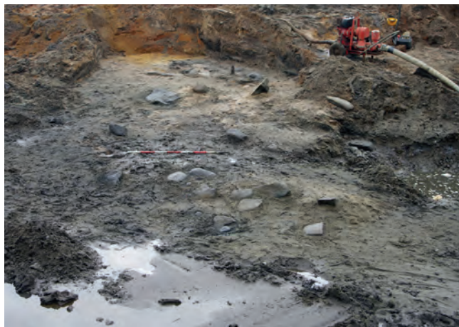
Vadestedet øst for broen er frilagt. I baggrunden ses pumpen, der arbejdede på højtryk det meste af tiden.
