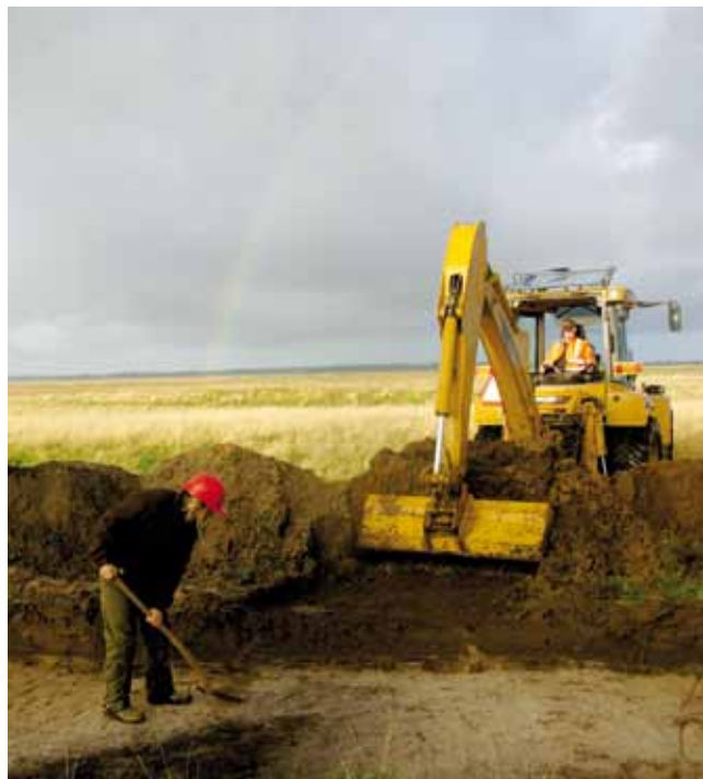
Ved gravemaskinens hjælp lykkedes det at finde "guldet" for enden af regnbuen. Nederst i billedet kan man ane konturerne af en systemgrøft, som er fyldt med gråsort sand. Undergrunden omkring den består af gult sand.
